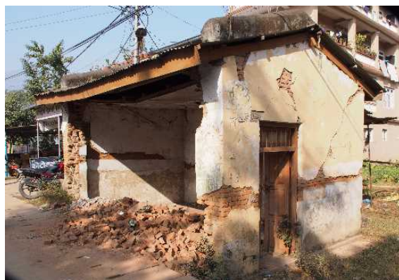
倒壊したヌワコット盲人協会事務所
