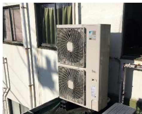
新設した室外機
